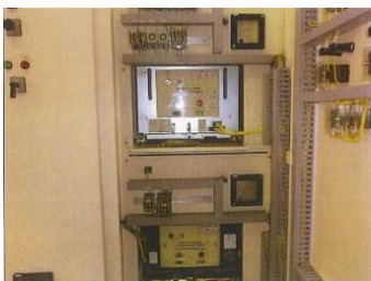
R 2 野球場変電設備VCB
